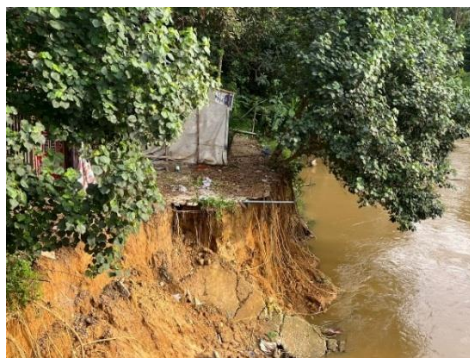
Gambar 2. Salah satu bagian tebing sungai yang mengalami erosi
