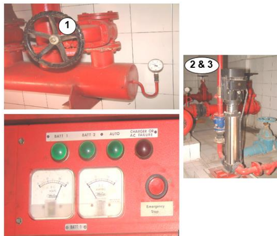
Gambar 1. Perawatan harian rumah pompa (Dokumentasi, 2018)
