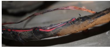
a) Kabel terkelupas
