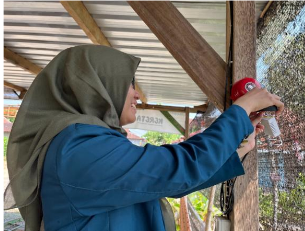
Gambar 4. Pemasangan Alarm Darurat di Wisata Lokamerta
