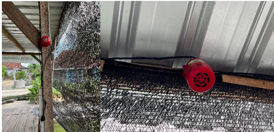
Gambar 5. Sistem Alarm Darurat yang Sudah Terpasang
