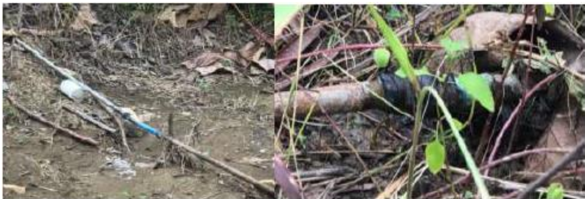
Gambar 2. Salah satu titik kebocoran pipa yang menyalurkan air mataair menuju ke pemukiman.
