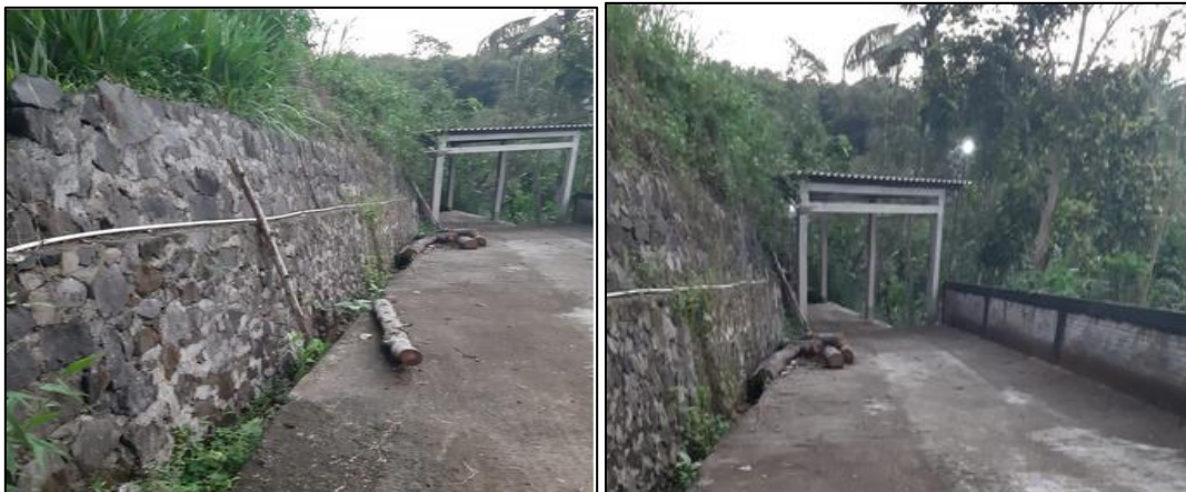
Gambar 5. Dinding Penahan Tanah dan Akses Jalan
