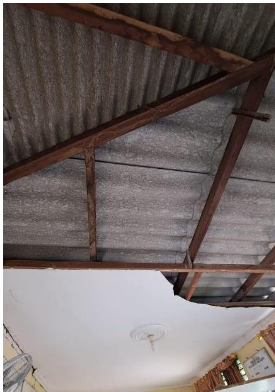
Gambar 1. Kondisi plafon ruang kantor MI Pancakarya
