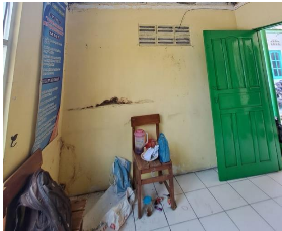
Gambar 2. Kondisi cat dinding ruang kantor MI Pancakarya
