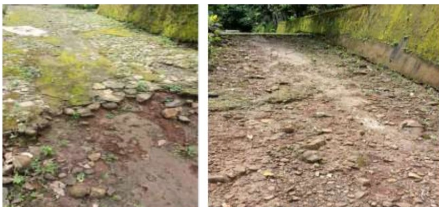
Gambar 3. Kondisi Jalan Eksisting Kondisi Setelah Hujan
