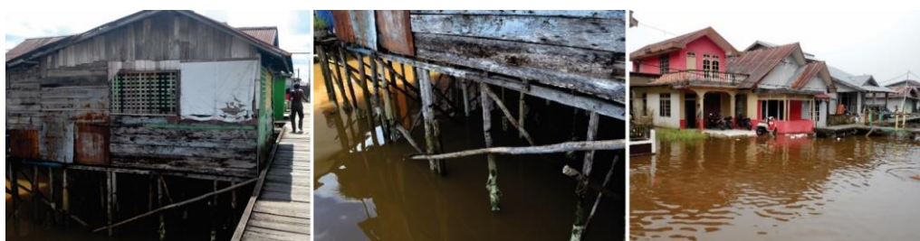
Gambar 3. Dampak Banjir pada Rumah Panggung
