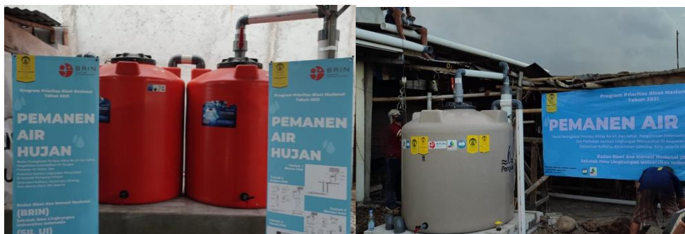
Gambar 7. Instalasi Panen Air Hujan
