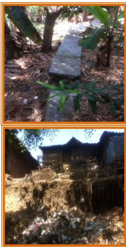
Gambar 1 Longsoran revetment di sungai Blorong
