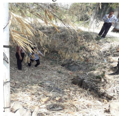
Gambar 3. Dinding saluran yang mengalami kerusakan
