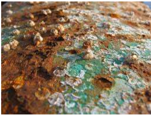
Gambar 1. Korosi pada lambung kapal
