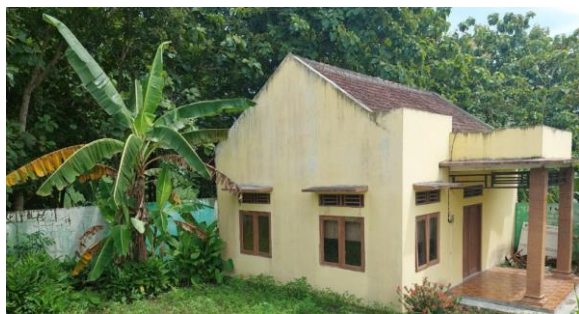
Figure 3. Kondisi salah satu bangunan eksisting di balai Desa Galeh
