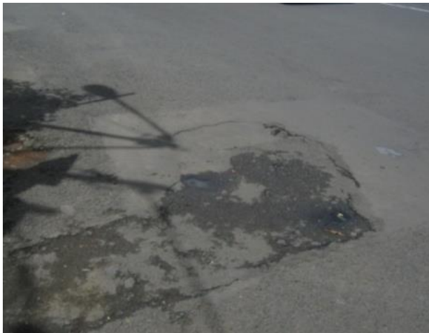
Gambar 5. Kondisi Perkerasan di Jalan Basuki Rahmat (segmen-1). Sumber: Hasil survei, 2015
