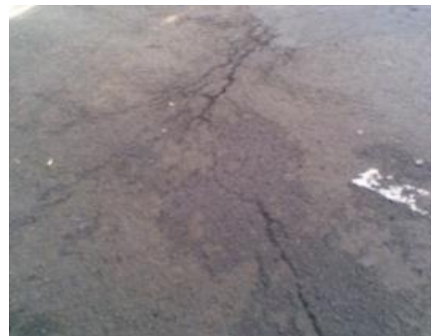
Gambar 7. Kondisi Perkerasan di Jalan Merdeka Barat. Sumber: Hasil survei, 2015
