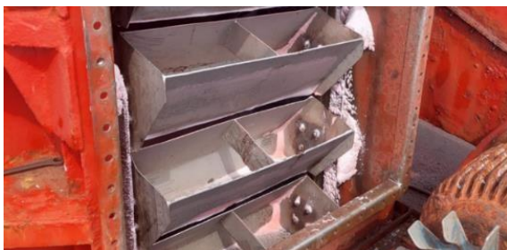
Gambar 7. Bucket elevator (Sumber: PT Pupuk Indonesia Logistik)
