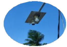
CCTV kamera (1.625 unit)
