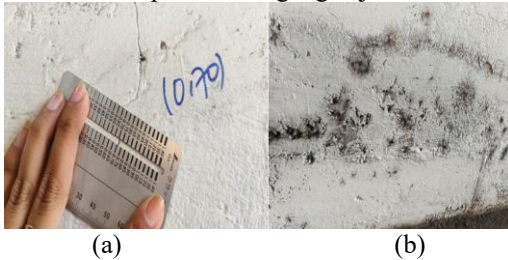
(a) (b) Gambar 5. Dinding tegak retak (a) dan dinding berongga (b)
