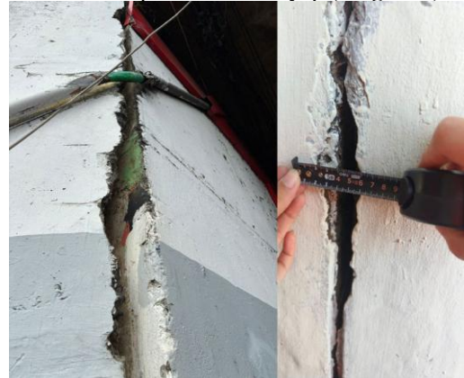
Gambar 7. Retak pada sambungan wing wall
