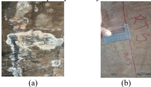
Gambar 4. Pelat atas jembatan berlumut (a) dan retak (b)
