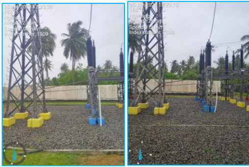
Gambar 4. Kondisi Pondasi LA yang perlu dilakukan perbaikan
