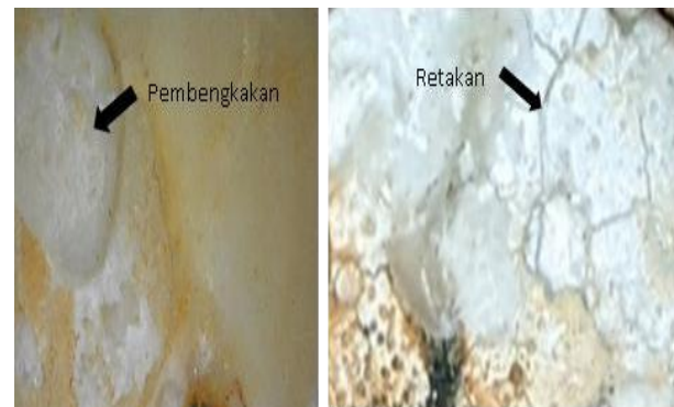
Gambar 6. Pembengkakan dan retakan disebabkan infiltrasi cairan SBF ke dalam material
