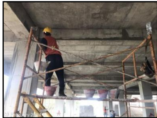
Gambar 8. Perataan permukaan balok dengan gerinda dan yang keropos kecil diperbaiki
