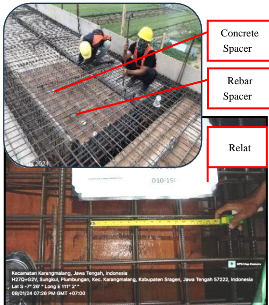
Gambar 7. Setelah perbaikan, jarak penulangan plat lantai diperbaiki sesuai desain rencana, penambahan concrete spacer (tahu-tahu), rebar spacer (kaki ayam) dan penambahan alat bantu relas, untuk stabilitas ketebalan plat lantai saat pengecoran
