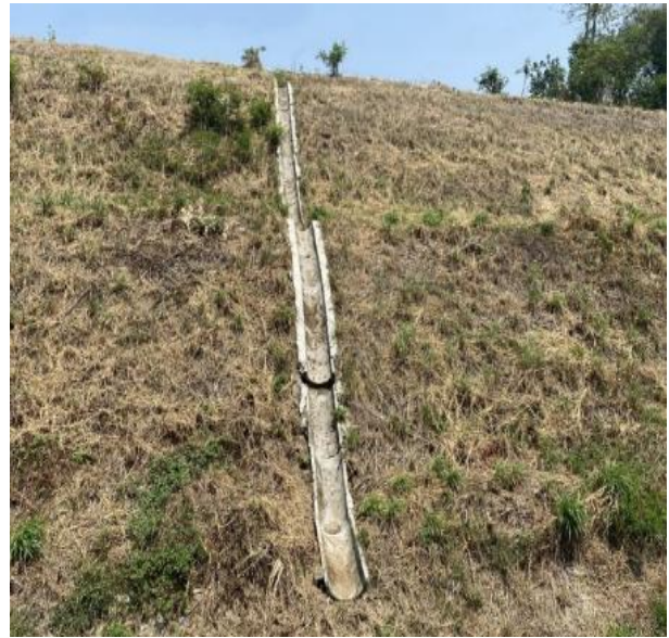
Gambar 6. Saluran drainase patah yang dibangun tidak sesuai dengan standar.
