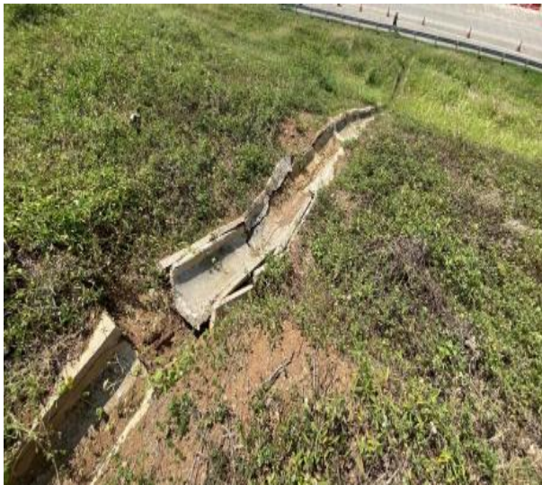
Gambar 5. Saluran drainase patah dan berpindah dari lokasi awalnya.
