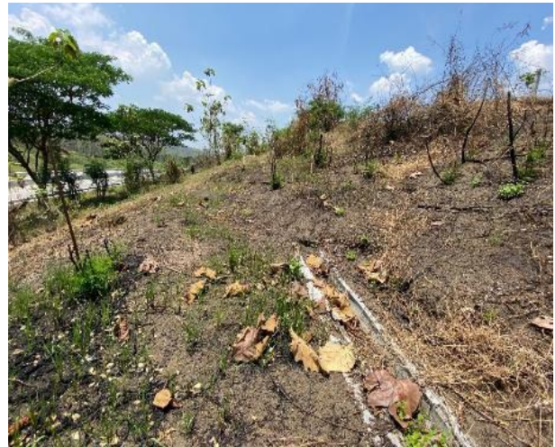
Gambar 7. Fase awal longsor yang diawali dengan rusaknya saluran drainase.
