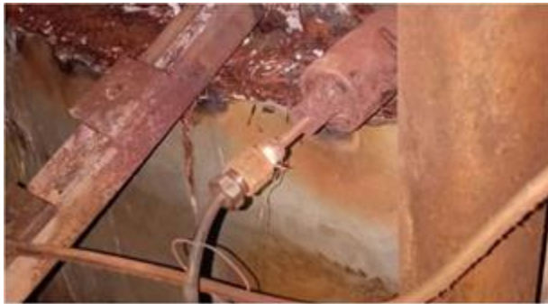
Gambar 7. Sensor temperatur yang mengalami kerusakan
