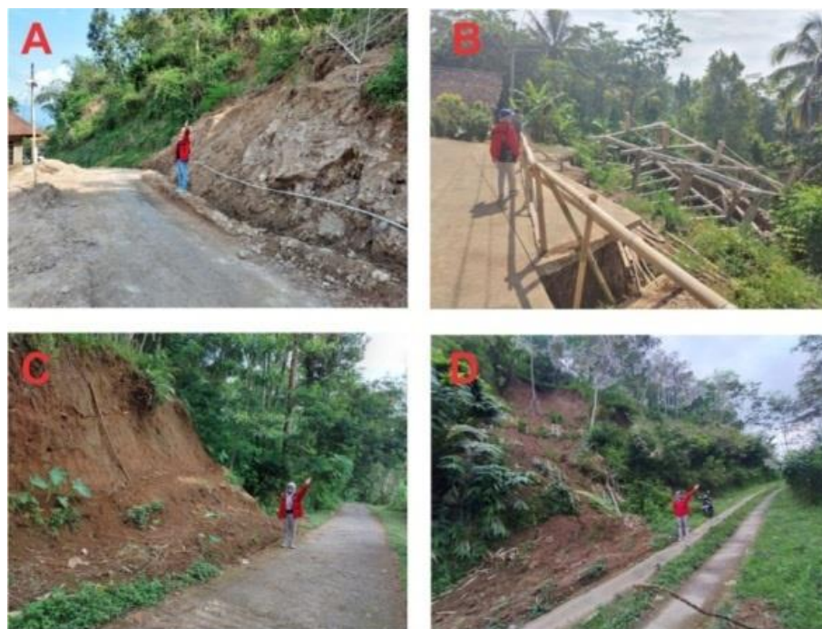
Gambar 9. Dokumentasi Kejadian Longsor di Lapangan (A) Kecamatan Windusari, (B) Kecamatan Kaliangkrik, (C) Kecamatan Salaman, (D) Kecamatan Borobudur.
