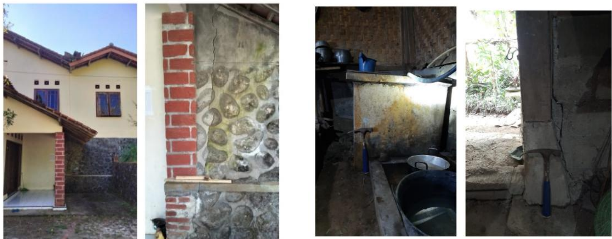
Gambar 11. Sebelah kiri merupakan rumah warga yang retak di sebelah SMP Negeri 1 Samigaluh dan sebelah kanan merupakan rumah warga yang retak di titik 26.
