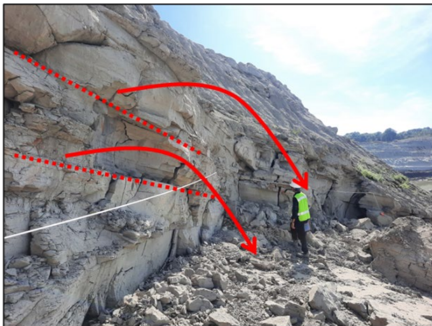
Gambar 22. Potensi Longsoran Toppling
