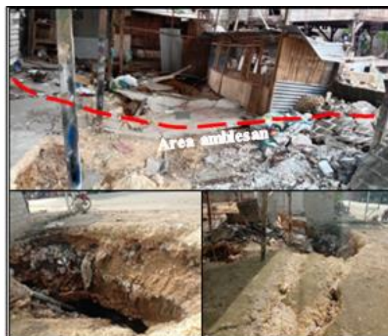
Gambar 7. Collapse sinkhole di Kecamatan Betoambari.
