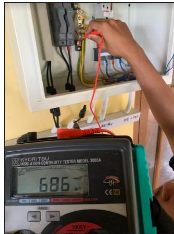
Gambar 7. Hasil Megger Test pada Grounding PLTS
