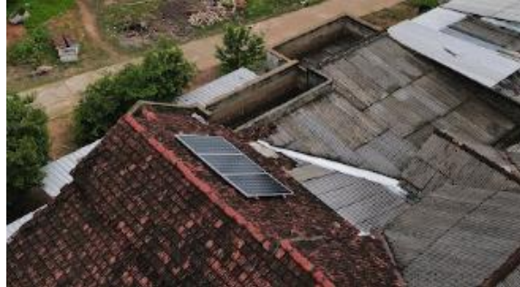
Gambar 5. Dokumentasi Instalasi PLTS Sebesar 1050 Wp
